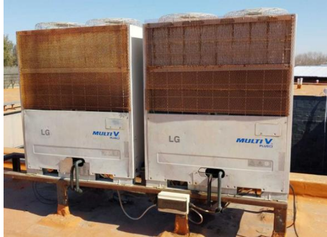
Imagen de los equipos a desinstalar
